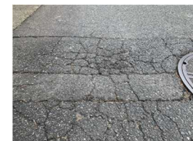
b) Crack (-6mm)
